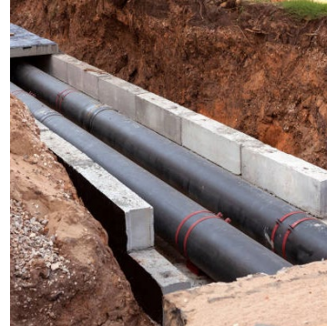
管路 約60万km
