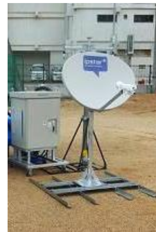
衛星回線設置
